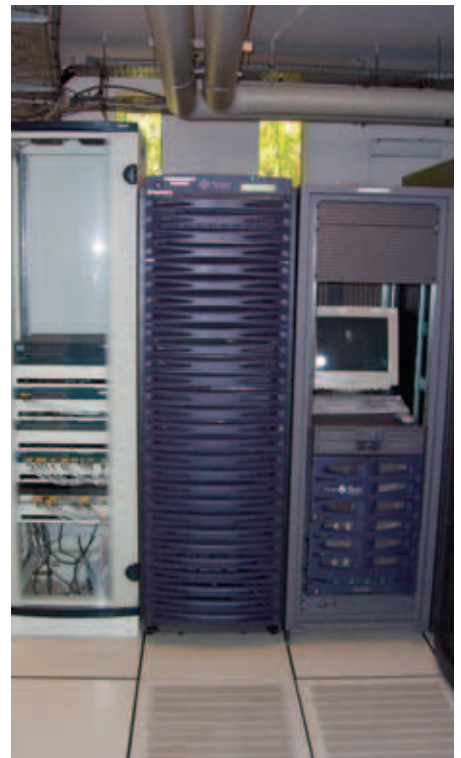
Salle machine des serveurs du Sudoc, Calames et Star Ces serveurs sont hébergés au Centre informatique national de l'enseignement supérieur (CINES) situé à Montpellier.
