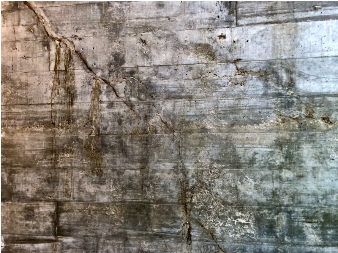
Détail d'un mur en béton brut de décoffrage du Museu de arte moderna de Rio de Janeiro (architecte Affonso Eduardo Reidy), achevé en 1955, partiellement détruit par un incendie en 1978
